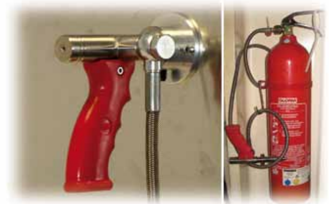
CO 2 -E-Löschnagel mit Arretierungsflansch und CO 2 -Feuerlöscher
